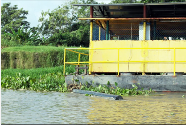
Vegetación acuática aguas arriba de la captación y tubería flotante.
