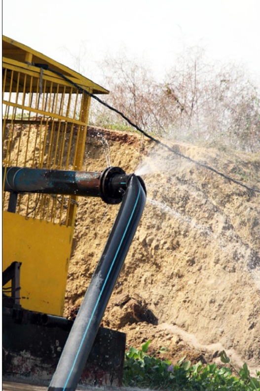
Vista de tubería estrangulada sometida a presión.
