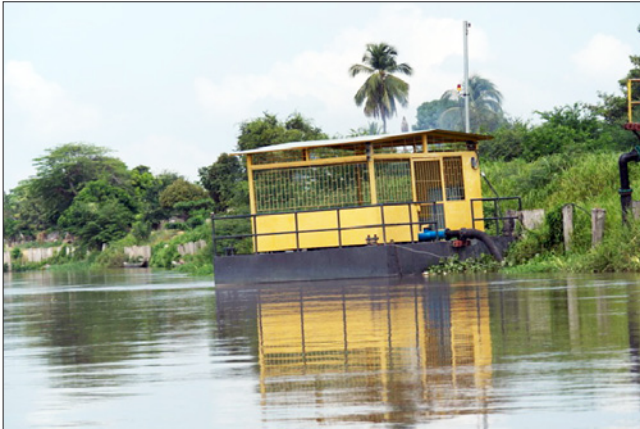
Captación y aducción de Santa Lucía
