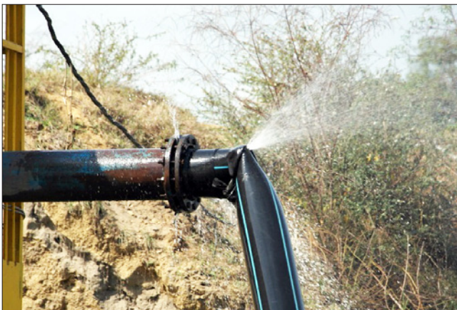
Vista de tubería estrangulada sometida a presión.
