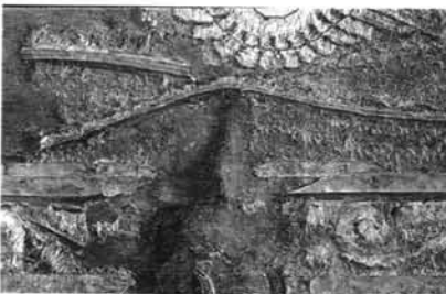
8.- Parte inferior central: grieta
