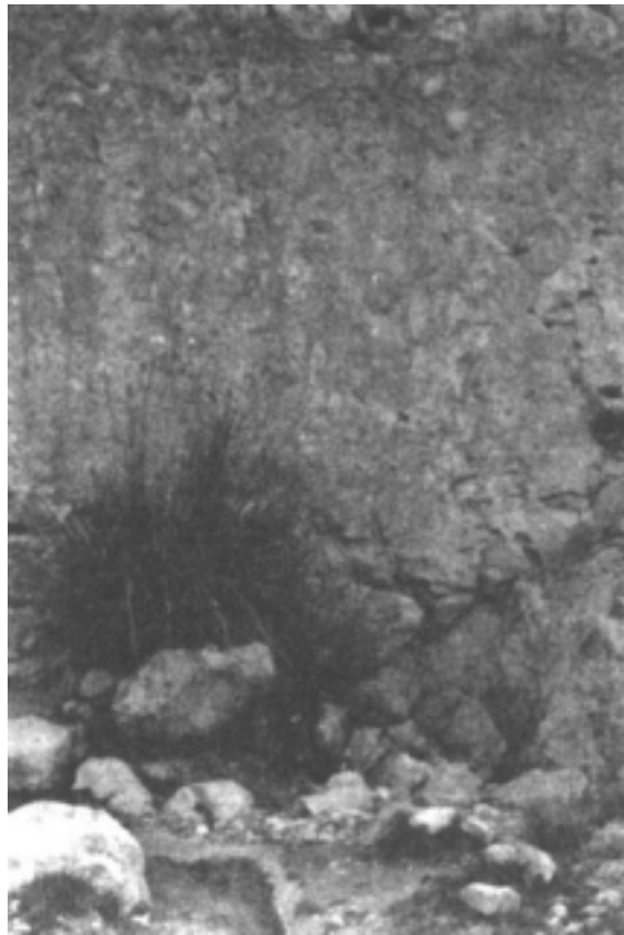
FOTO 5. Surgencia subálvea actual de la presa de la Murtera.
