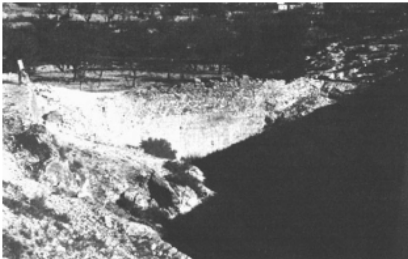
FOTO 4. Presa de la Murtera. Detalle de su construcción, donde se puede observar las gárgolas de sangración hídrica y el recrecimiento motivado por la colmatación de la primera fase de construcción.
