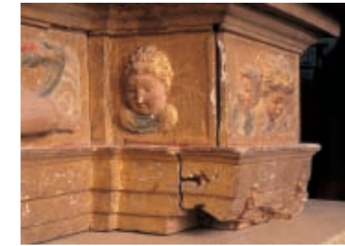
Figura 11. Daños en la arquitectura de los retablos: a) hundimiento del fondo de una hornacina; b) efectos de manipulaciones inadecuadas.
