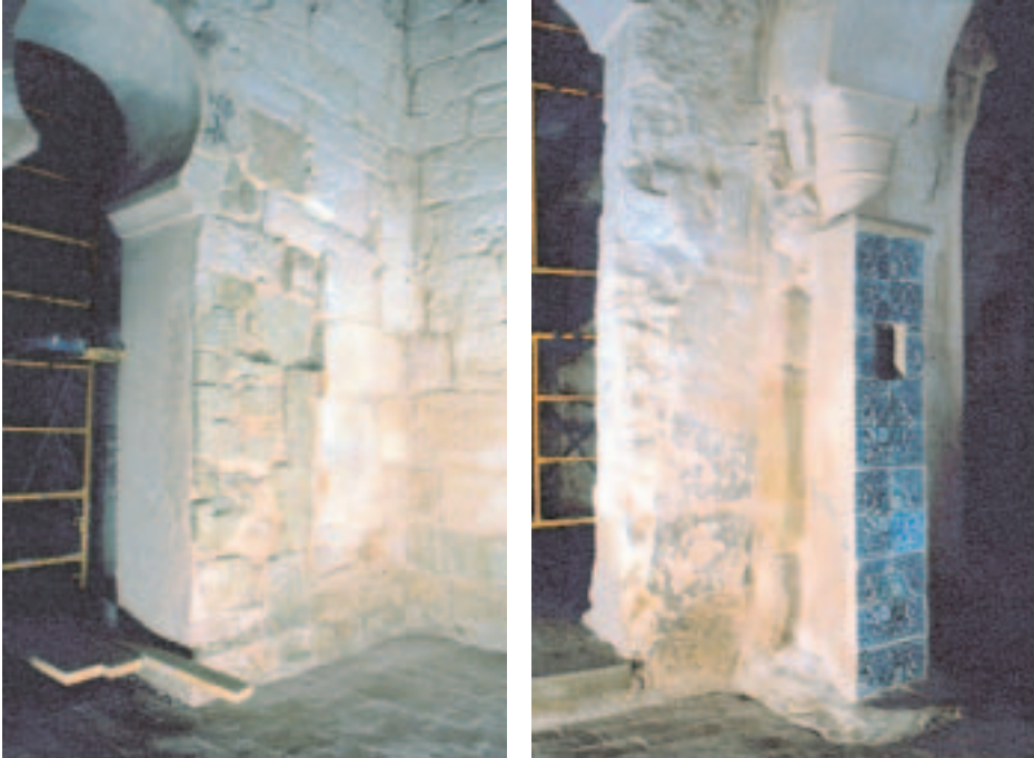
Fig. 14. A) Esquina noroeste de la cabecera sur. Muro premozárabe cortado y sobremontado por el arco y el muro mozárabes; B) Nave norte. Arranque de la arcada mozárabe con resto de muro premozárabe y columna mozárabe restaurada con madera tras el incendio y conservada en un relicario moderno.
