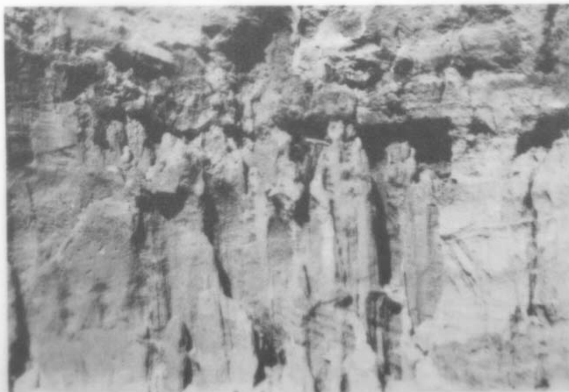
Foto 14: Erosión en chimeneas. 7.ª Parada.
