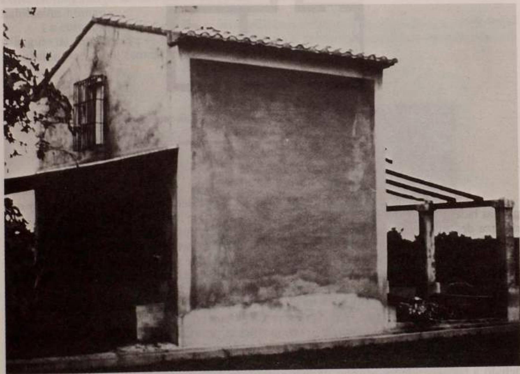
Fig. 49. Perspectiva posterior de la casa. Se puede observar el estado en que se encuentra tras un incendio presumiblemente provocado según el propietario.
