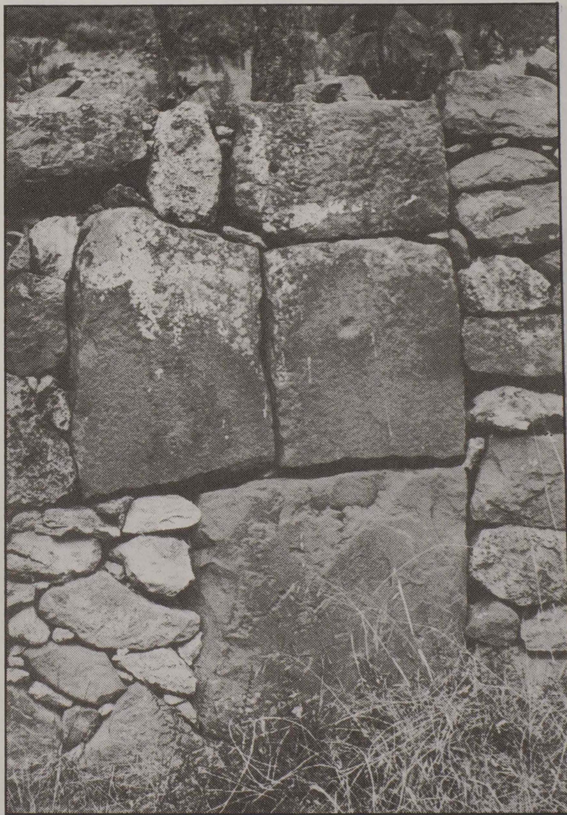
(Làm. IX b.) — Carreus d'una antiga construcció aprofitats per fer marges vora el Camí Vell de Vilafamés
