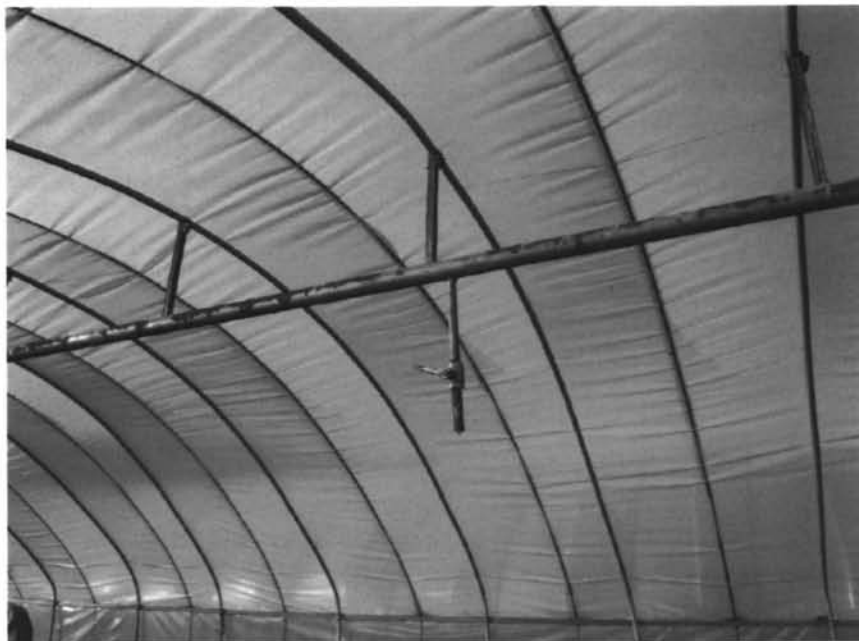
Imagen 14. Detalle del sistema de nebulización de un invernadero “tipo Kunming”
