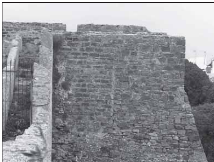
Imagen 3.- Detalle de la cara occidental de la Torre de los Maderos. Obsérvese la torre primitiva forrada por la obra moderna ataludada*.
