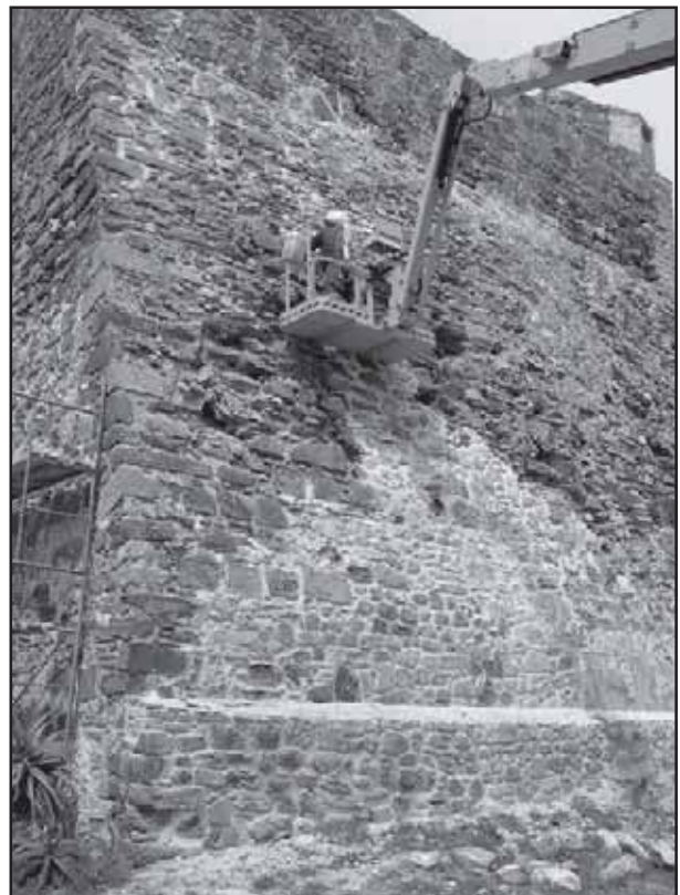
Imagen 8.- Detalle de la cara meridional de la torre durante la ejecución de los trabajos de consolidación.
