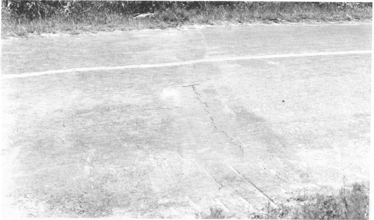
Figura 9.- Grieta sobre la carretera Ixtlahuaca-Jilotepec. Inmediaciones de Ixtlahuaca.
