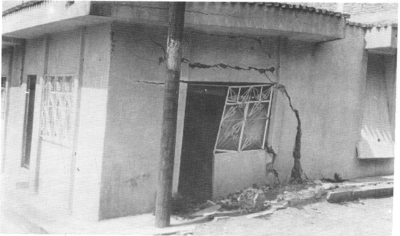
Figura 10.- Efectos de los agrietamientos actuales en Abasolo, Gto.; medio urbano.
