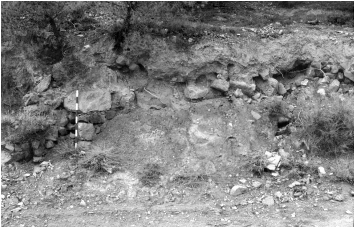
Figura 15. Muros en el corte del camino, al Norte del muro de contención y de la arqueta.
