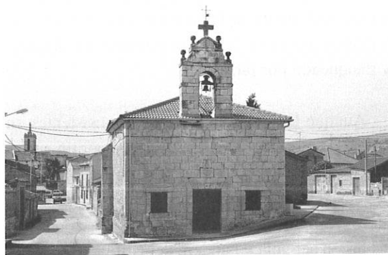
Figura 36.- En la ermita de la Concepción de Fuentecén la espadaña del frente impide la evacuación de aguas en la vertiente donde se levanta.
