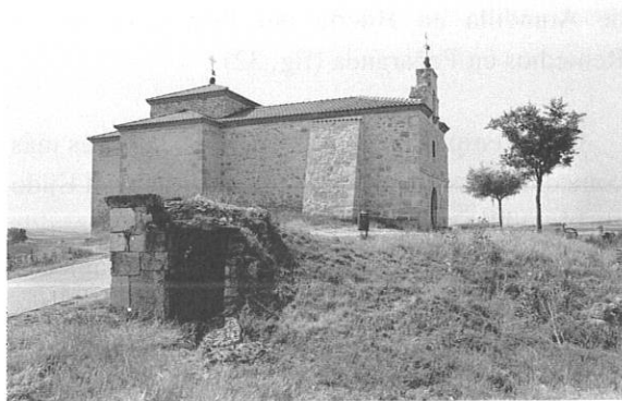
Figura 34.- La ermita de San Juan en Anguix precisó un sólido contrafuerte en el muro norte, posiblemente por un fallo de cimentación por levantarse en el cerro de las bodegas.
