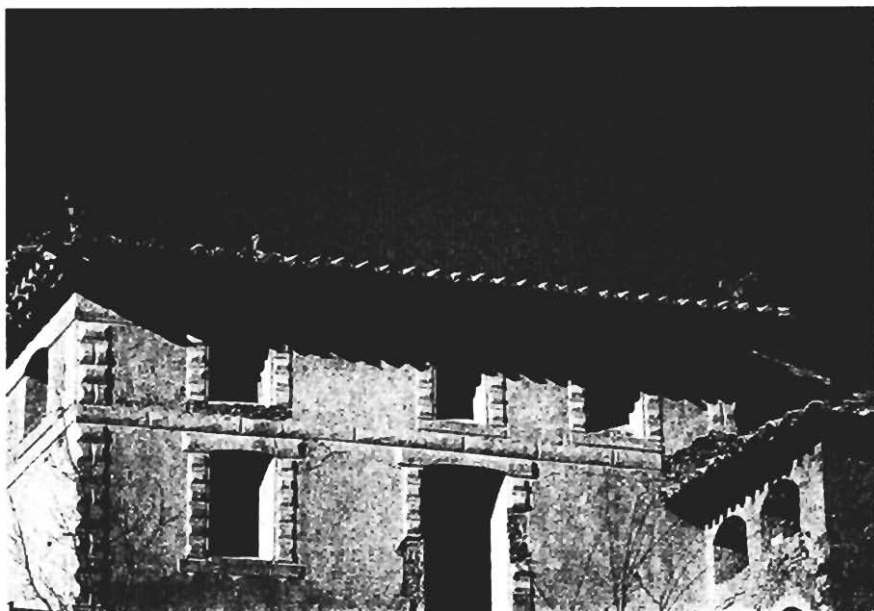
Detalle del tejado de la denominada Casa El Albañil de Caballera. Foto: J. L. Acín.
