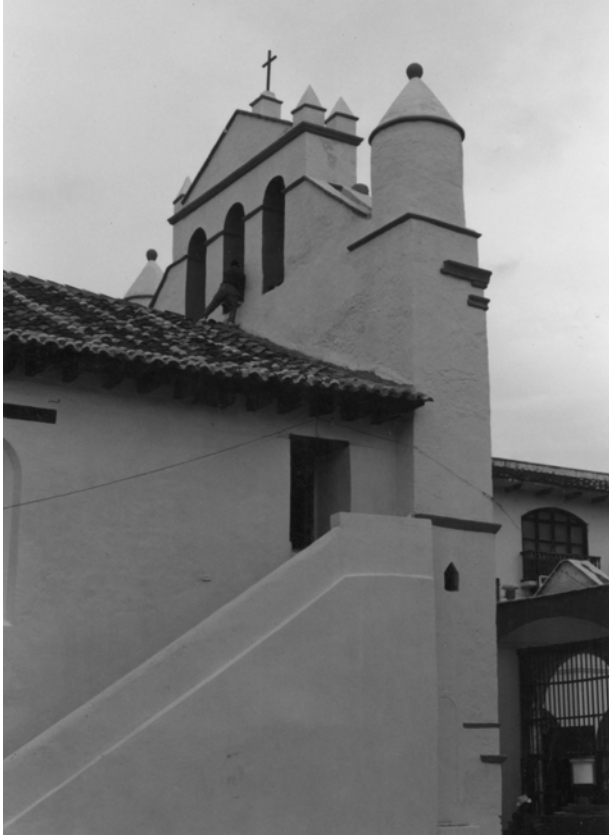
Izquierda: El templo de San Nicolás en obras de restauración. Octubre de 1992
