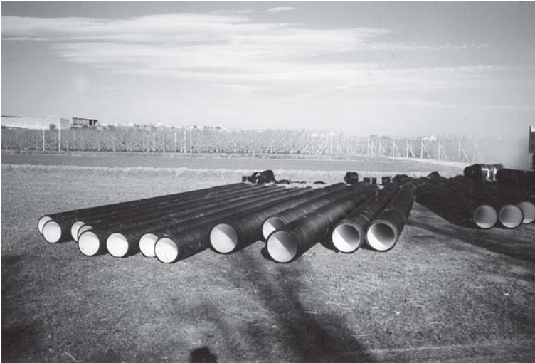
Tubs de plàstic especials utilitzats en la canonada de conducció per a l'Estació d'Aigües Residuals, ubicada al Camí de Lleida. Any 2000. Fotografia: J.Civit.
