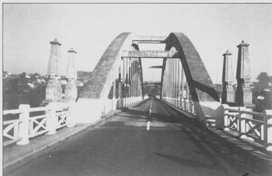
8- Dous puntos de vista do arco central, o elemento máis destacado da ponte. Exemplo da enxeñería dos anos 30, atrevida no seu deseño, esta ponte parece ter xa feito o seu labor. Novas solucións, urxentes, decidirán o futuro desta obra de formigón.
