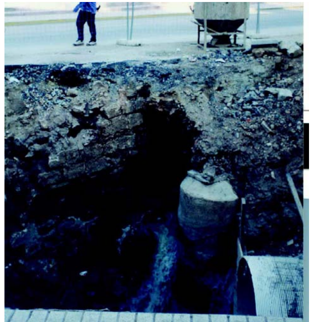
Restos de un antiquísimo puente descubierto durante unas obras de canalización en el lugar de la Fuente del Pisar.
