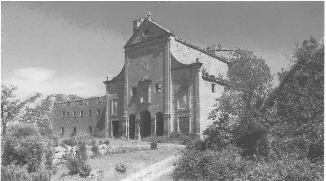
Aspecto de la Iglesia del imponente Convento del Desierto de Calanda. La zona inferior de su fachada está repleta de pintadas y "graffiti" recientes realizados con pinturas aplicadas con aerosoles.
