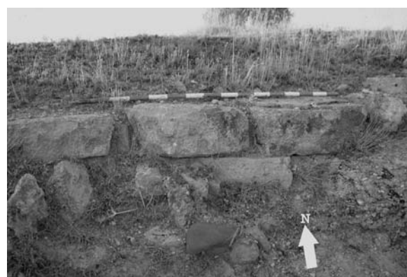
Lámina 22. Detalle de los restos de la muralla del recinto superior del yacimiento andalusí de Tozal López (La Puebla de Castro, Huesca), de la que se conservan dos hiladas de sillares irregulares.
