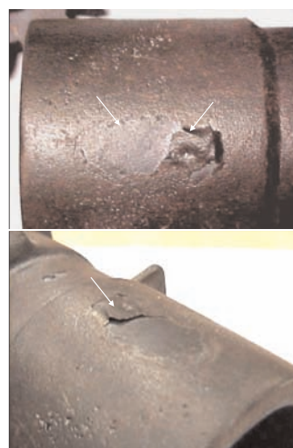
Figura 15. Sopladura deformada por la presi n del metal l quido durante la colada.
