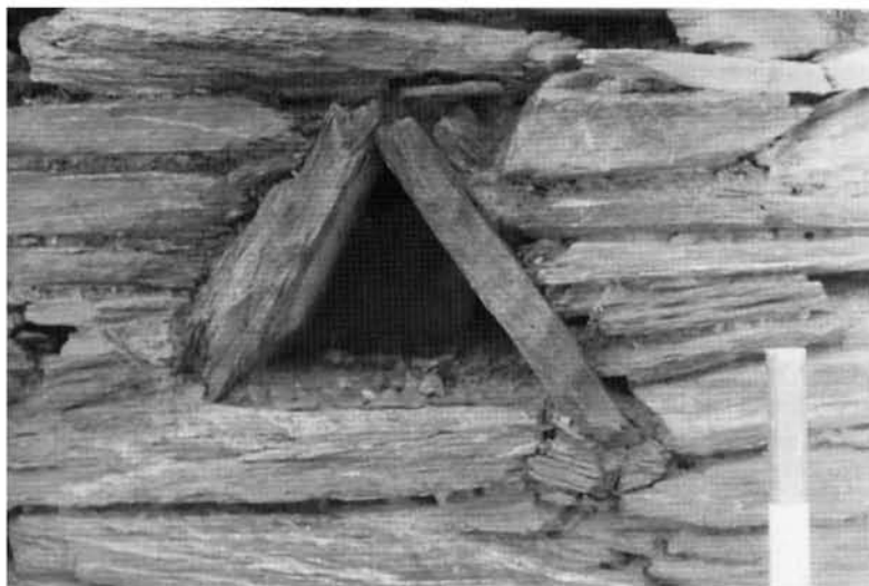
Lám. IV. Cuesta Roca (Senés). Nicho triangular en el muro sur (104) del patio.
