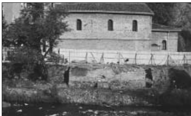
Foto 3. Vista de las obras de excavación con la actual ermita de los Santos Mártires (Bergara) al fondo.
