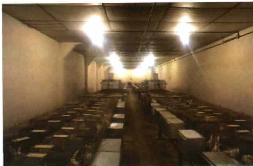
Instalacion de ambiente controlado, con refrigeración por humidificación y limpieza con agua a presión.
