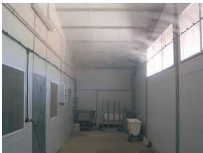
Las naves cuentan con un pasillo acondicionador por medio del que entra el aire, que se calienta, por medio de un sistema de calentadores de gas, o se enfría, mediante humidificadores, además el pasillo hace las veces de almacén
