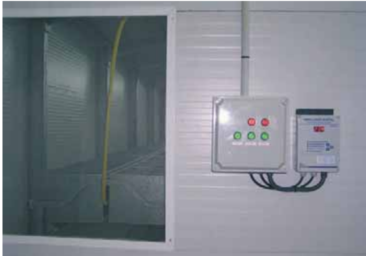
Todo el sistema de ventilación está controlado por un regulador en el que se programan las necesidades, máximos y mínimos de temperatura, etc.
