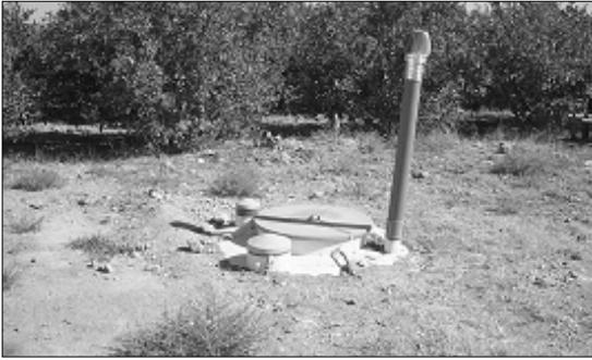
2.- Cuba de hidrolización instalada para su uso.
