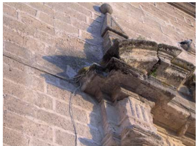
PORTADA DE LA CUESTA. CABLEADO SOBRE LOS PARAMENTOS, COLONIZACIÓN DE HONGOS Y LÍQUENES
