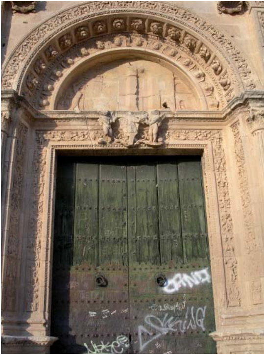
PUERTA DE MADERA DEL SIGLO XVIII. REPINTADA, CON GRAFFITTIS Y OXIDACIÓN DE ELEMENTOS METÁLICOS
