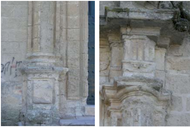
ATAQUE BIOLÓGICO, FRACTURAS CON PÉRDIDA DE MATERIA, ARENIZACIÓN, DISGREGACIÓN, EROSIÓN Y DESCAMACIÓN.
