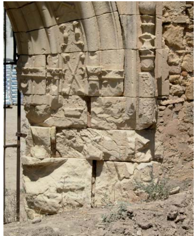
ESTADO ACTUAL DE LA JAMBA DERECHA DEL ARCO DE SAN LORENZO.
