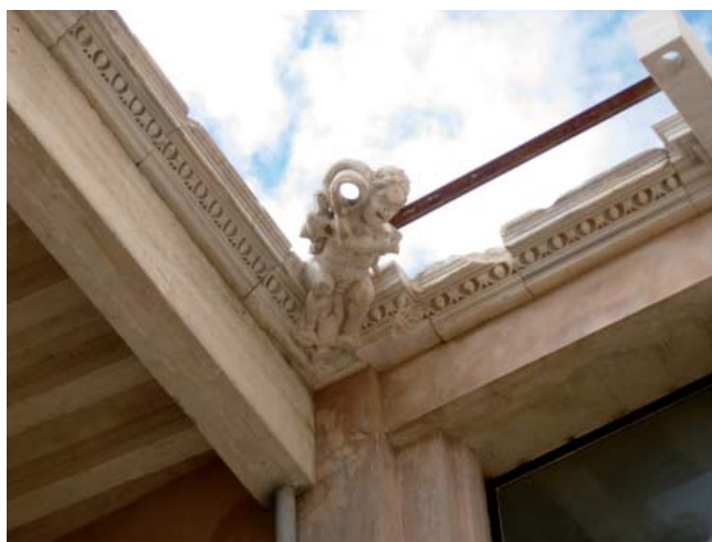
LO POCO QUE QUEDA IN SITU DE LA DECORACIÓN ARQUITECTÓNICA DEL PATIO DEL CASTILLO DE VÉLEZ BLANCO.
