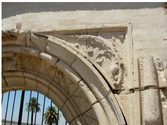
EN EL INTRADÓS DEL ARCO SE ENCUENTRA LOS RELIEVES DE PASIÓN, EN LAS ENJUTAS LOS DELFINES. DELANTE DEL MORRO DEL DELFÍN SE APRECIA UNA JUNTA MUY GRUESA QUE EVIDENCIA UN ERROR EN EL REPLANTEO DE LAS DIMENSIONES DE LOS SILLARES
