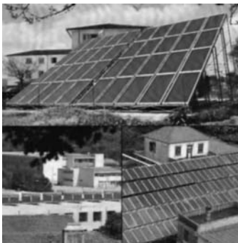
FIGURA 2. DIVERSAS INSTALACIONES DE CALENTADORES SOLARES DE AGUA PARA USO RESIDENCIAL Y DE SERVICIOS
