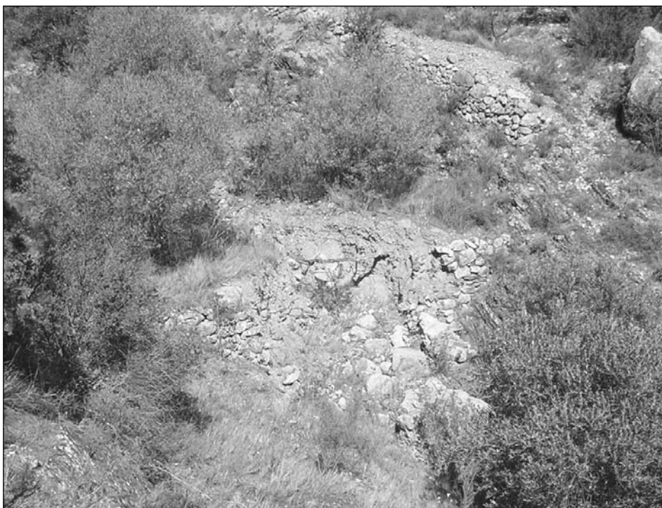
Soscavació en el torrent de Los Hortells , la Vilella Baixa (Priorat)
