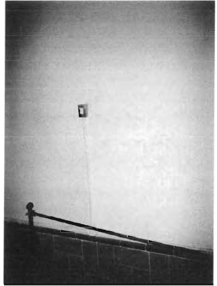
Foto 8. Instalación eléctrica antigua. Detalle
