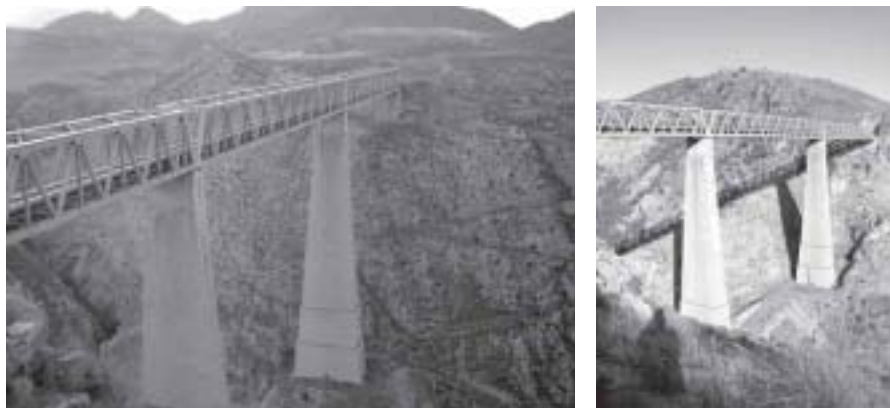
Puente del Salado. Vista desde el lado de Linares (foto izquierda) y de Almería (foto derecha).
