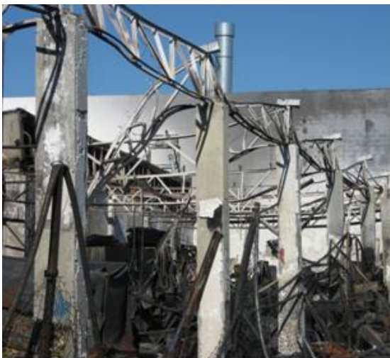
Figura 13 Deformaciones de estructura de acero
