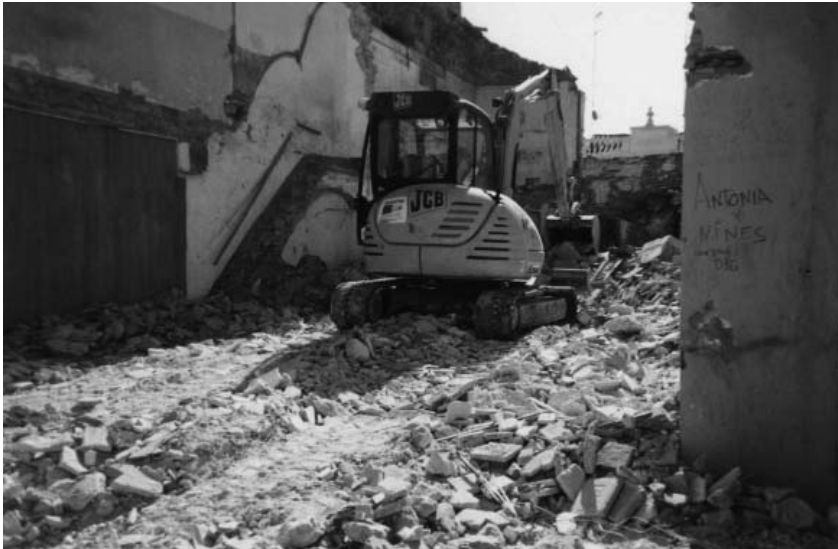
Derribos en el bulevar San Pedro. Foto tomada en el taller de fotografía por uno de los menores.
