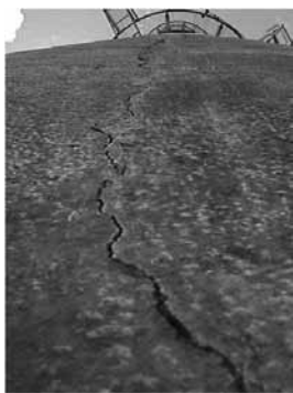
Figura 5. Fisura vertical en el fuste de la chimenea.
