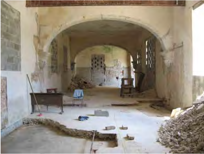
FIG. 4. Vista del local AB 11-13 desde el extremo oeste, donde se aprecian los dos arcos que lo distinguen
