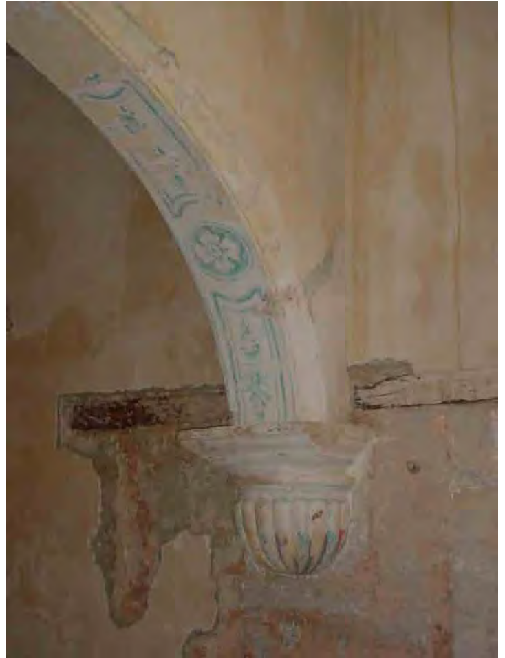
FIG. 6. Vista del arranque del arco oeste donde se aprecia el vano tapiado y el dintel cortado
