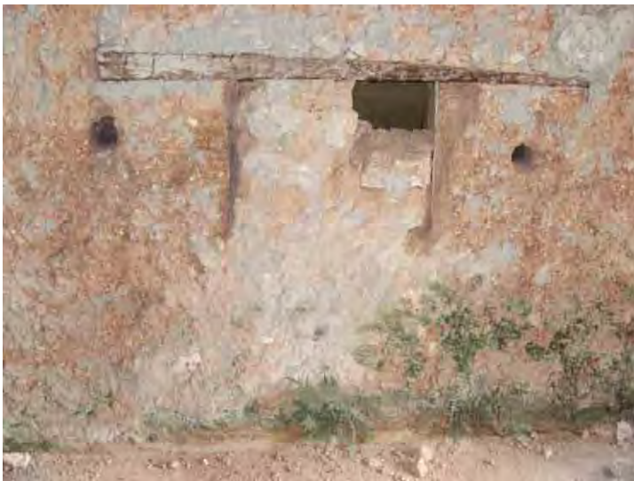
FIG. 3. Vano tapiado en el local AB 13-14
