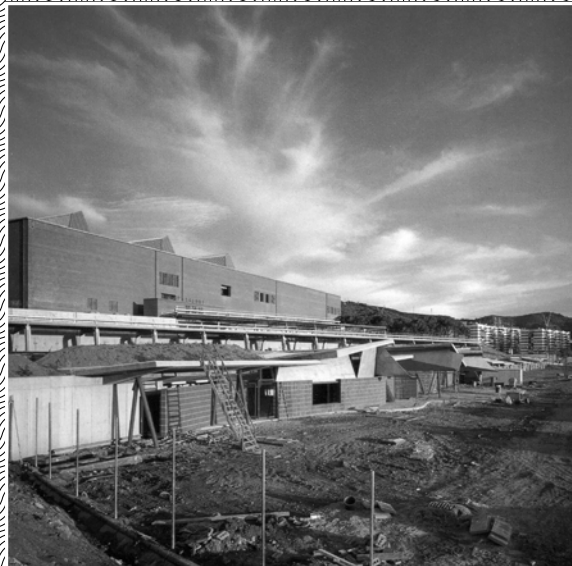
02 LAS INSTALACIONES DE ENTRENAMIENTO DE TIRO CON ARCO COMO PODIO SOBRE EL QUE SE ASIENTA UN INDIFERENTE PABELLÓN DE PELOTA. FOTOGRAFÍA DE HISAO SUZUKI, PUBLICADA
