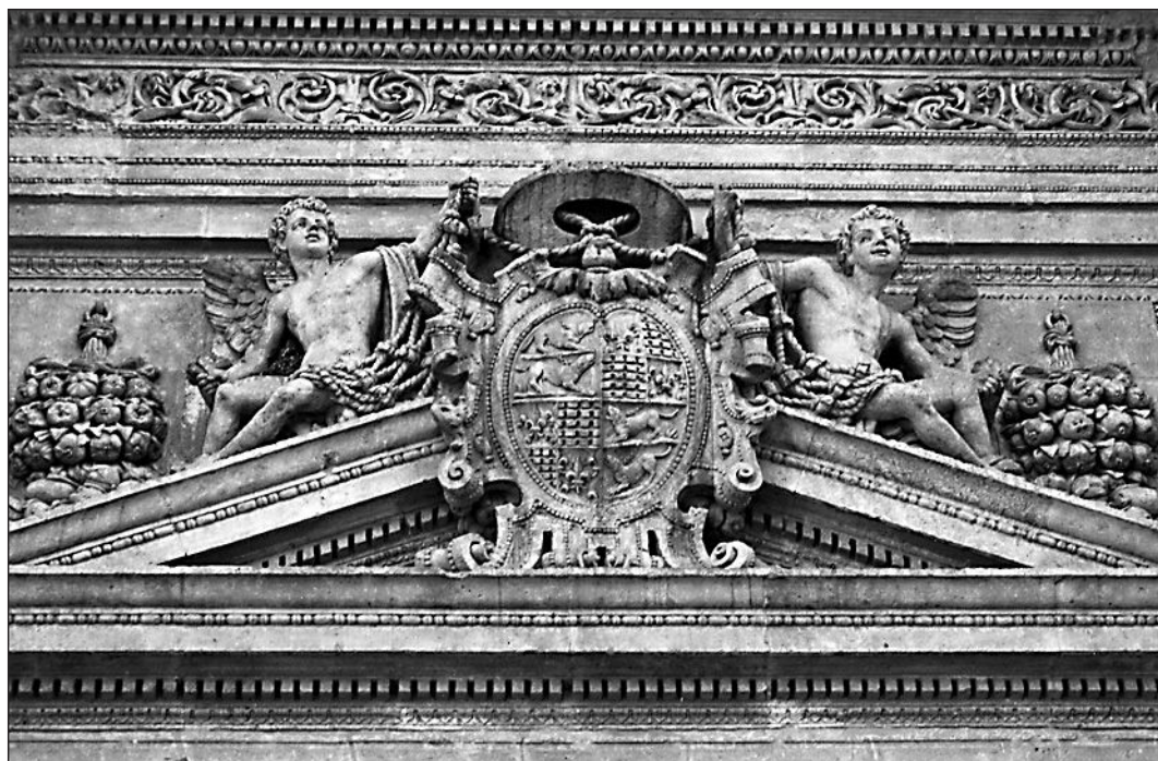
Frontón triangular que corona el gran vano adintelado de la fachada norte.
