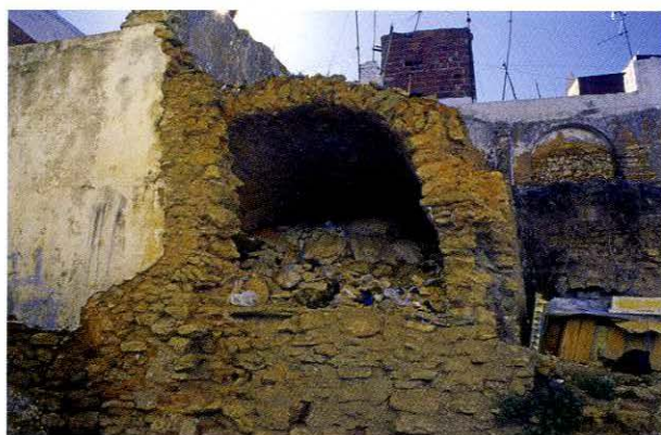
Fig. 18: Restos de la muralla del frente de tierra invadidas por las casas de la ciudad. Fotografía del autor.
