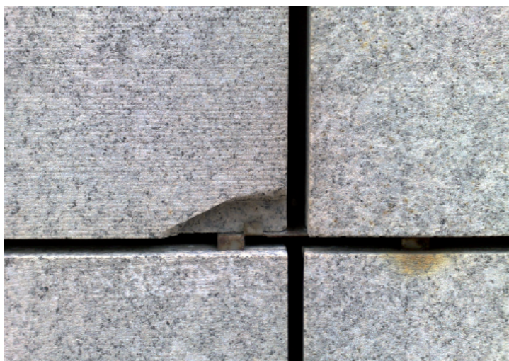
3 Lesión en una fachada ventilada de piedra en A Coruña; rotura en la acanaladura de la placa de granito sustentada con uñas de acero inoxidable. Se aprecian manchas de óxido del anclaje por la cercanía del mar.
