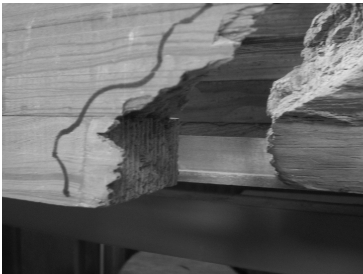
Figura 6. Apreciación visual de una unión finger joint ubicada en la zona de tracción, de una de las vigas estudiadas, contribuyendo a ocasionar la falla del elemento laminado al momento del ensayo. (Foto: Wilver Contreras Miranda)
