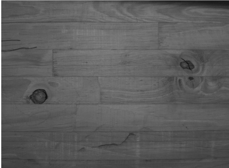
Figura 5. Apreciación visual y técnica de la cantidad y tamaño de los nudos en las láminas de madera que conforman una de las vigas laminadas realizadas con la técnica de finger joint . Se puede apreciar el mal uso de esta técnica al quedar, en este caso de estudio, las uniones muy cercanas entre sí, lo cual ocasiona la falla y una menor resistencia del elemento laminado al momento del ensayo. (Foto: Wilver Contreras Miranda)
