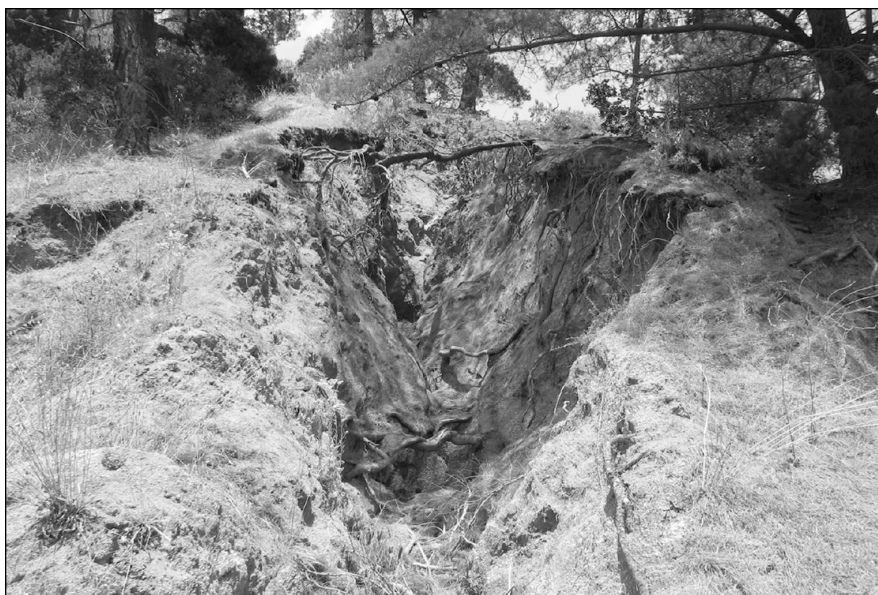
Figura 15. Erosión en zanja (cárcava) en un sector de ladera de la Quebrada de Córodova.
