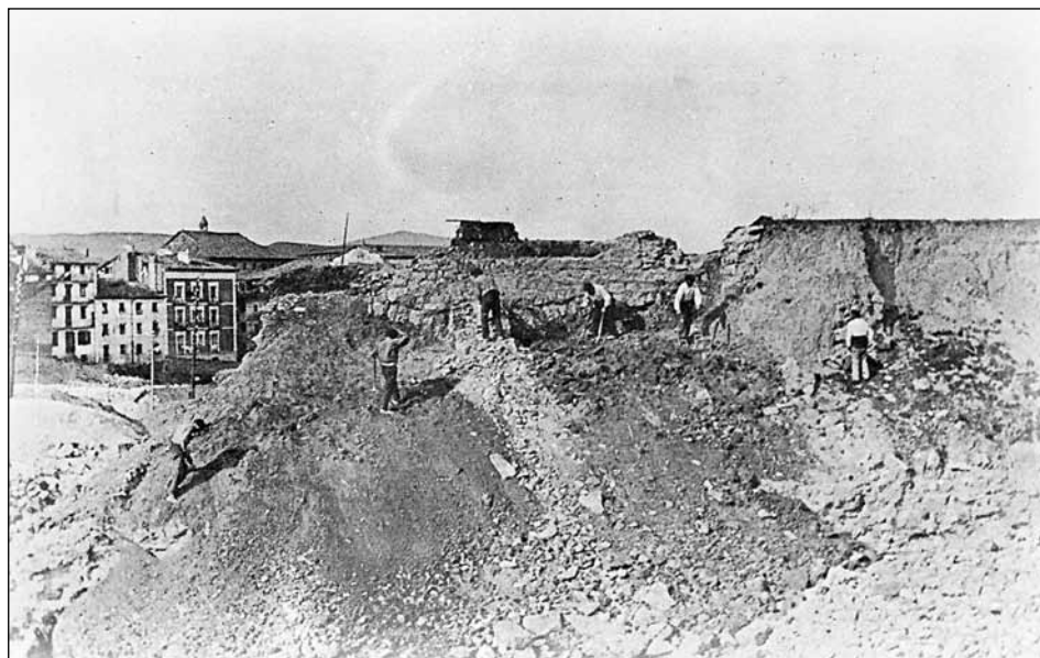
Año 1921. Utilización de layas en el derribo del baluarte de la Reina (foto J. J. Arazuri).
