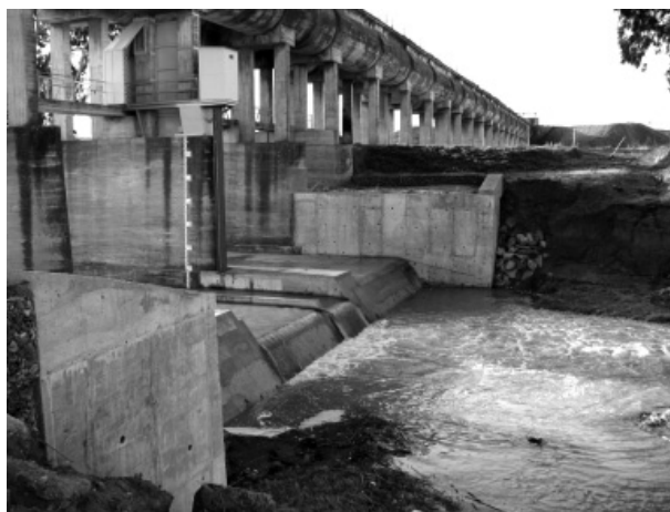
Figura 2. Estación de medición Aforos 152
