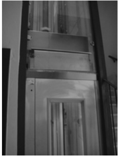
Ascensor incorporado junto al patio de c/ Álvarez, 1
