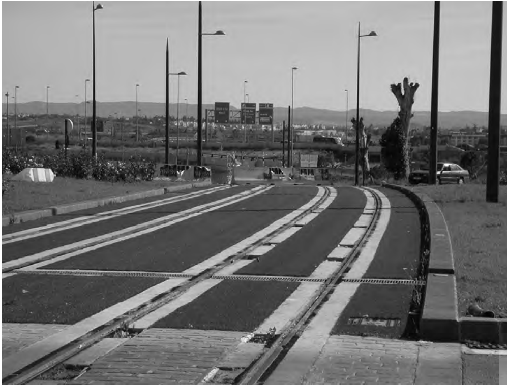
Figura 3. Trazado de la vía del metro a su paso por el PTS Granada.
