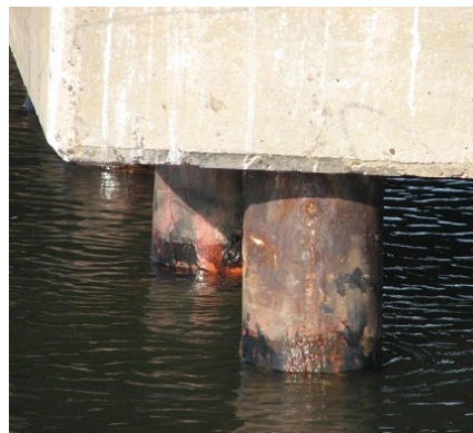
Figura 9. Estado inicial de los pilotes
