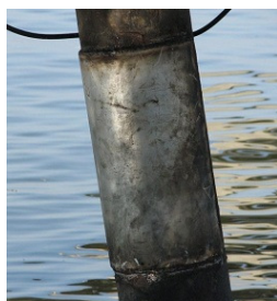
Figura 3. Soldadura de casquetes en zona de pérdida de material
