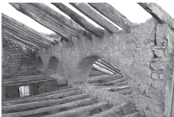
Lám. 2: Detalle de recrecimiento de los arcos y de la estructura de la cubierta, siglo XX.
