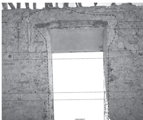
Lám. 9: Paramento 8002. Extremo este. Detalle de fábrica de 1710, ventanal de 1759 y reformas del siglo XX.
