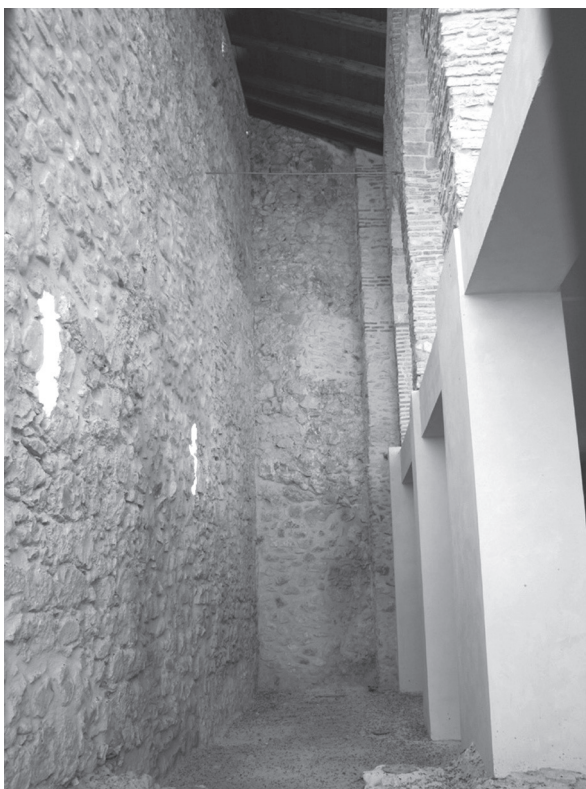
Lám.13: Interior del pósito tras su recuperación. Restauración del paramento del torreón de la esquina sureste.
