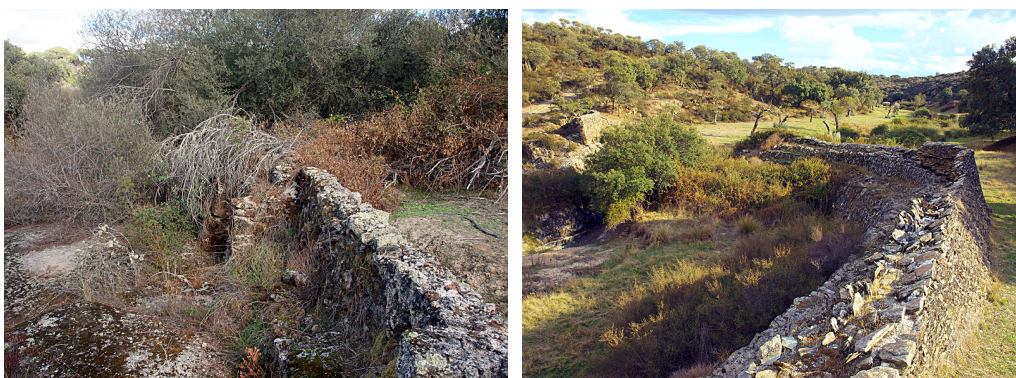
Figuras 18 y 19. A la izquierda, presa de contrafuertes del molino conocido como «de la Señora Montinegra», cercano a Garrovillas, con un interesante sistema hidráulico. A la derecha, restos de presa en arco en el arroyo Morisco; ambas presas llevan aparejados interesantes sistemas hidráulicos, incluyendo molinos harineros. Pensamos que son anteriores al siglo XVIII.
