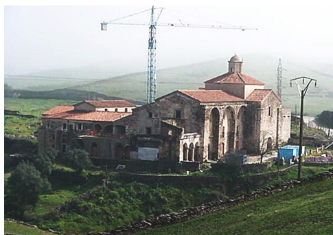
Figura 16. Exterior del Convento franciscano de San Bartolomé durante las obras de construcción de la Hospedería.
